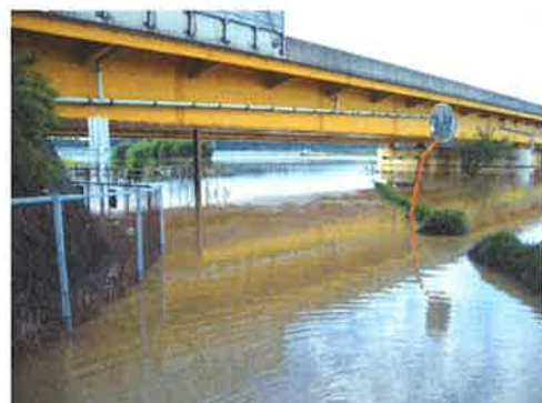
<平成23年9月・台風15号による出水 ：常磐道直上流付近>
